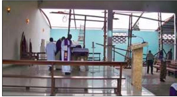
La toiture de l'église Saint-Augustin de la Tsiémé endommagée.
