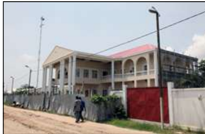
Construction de la mairie de Mossaka, grâce à la municipalisation accélérée du département de la Cuvette.
