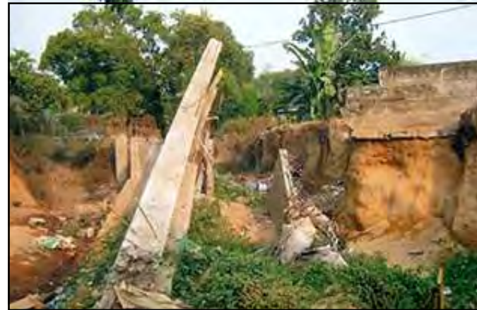
La canalisation construite avant n'a pas résisté à la furie des eaux...
