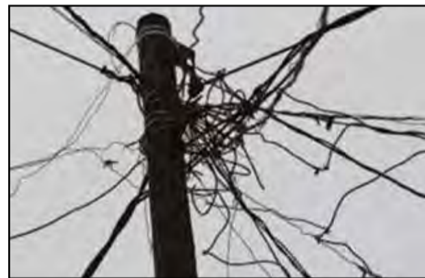
Un poteau d'électricité surchargé.
