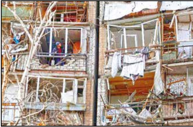
Un immeuble endommagé par l'explosion d'un missile russe
