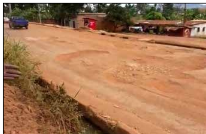
L'état de dégradation des routes
