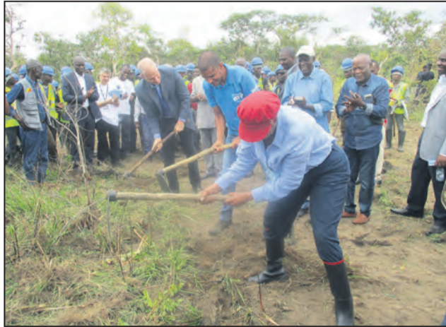
La ministre procédant au lancement des travaux de réhabilitation de la piste agricole
