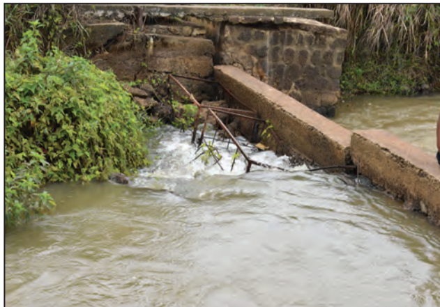
La digue rompue
