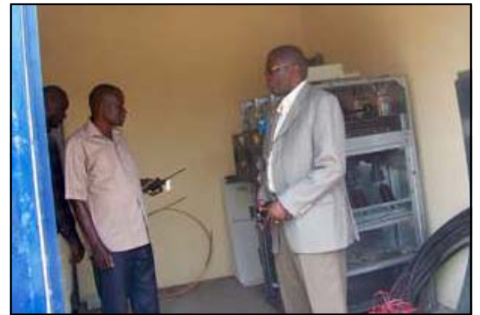
Marcel Arsène Bouity devant le transformateur du quartier Kibouendé
