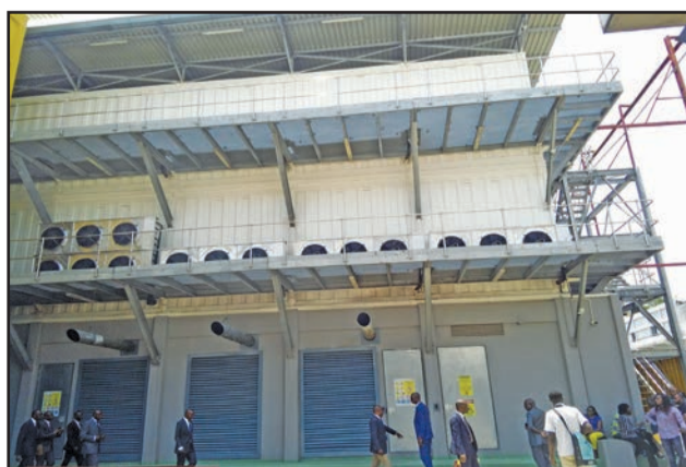
Une vue du Data center
