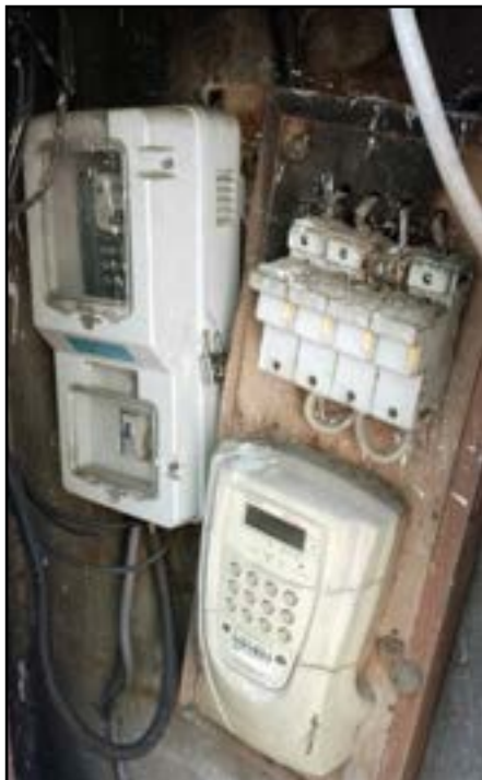
Une vue des compteurs
