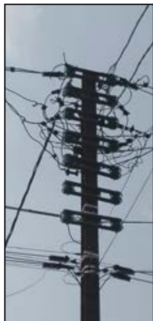
Un poteau électrique surchargé
