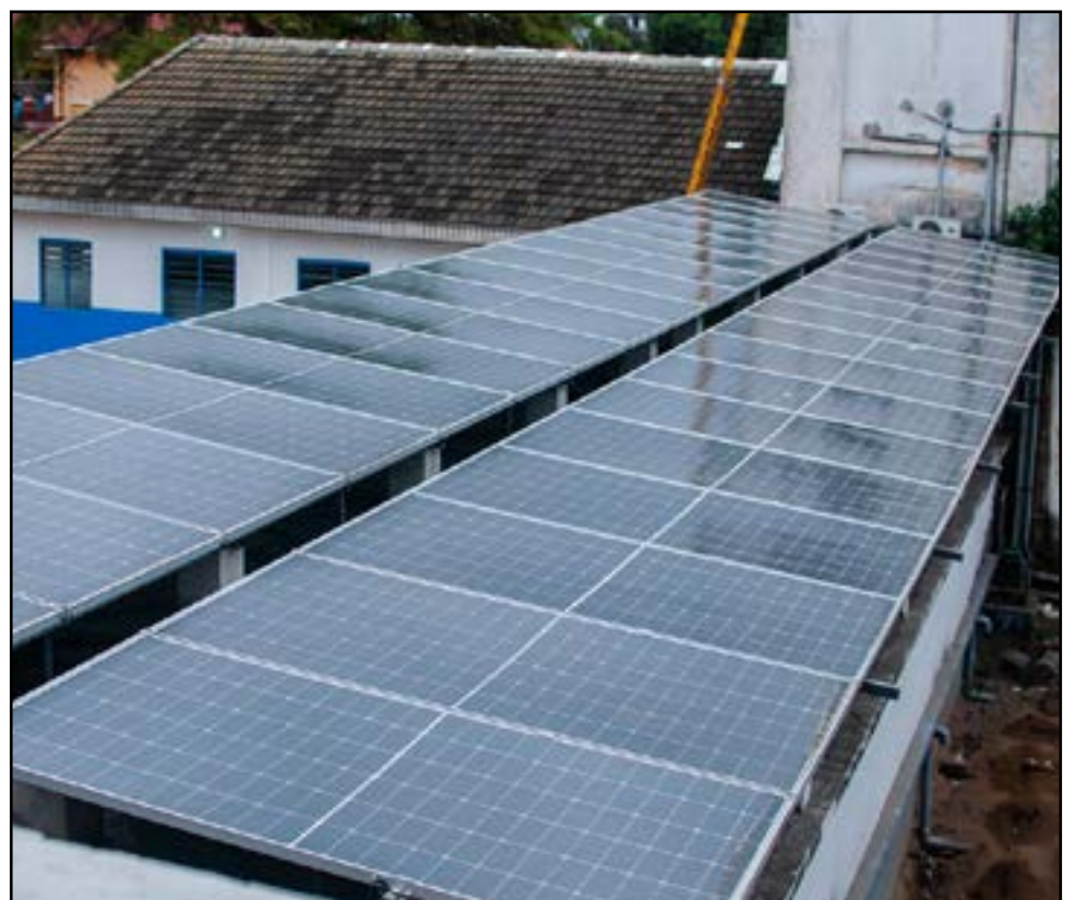
Une vue des panneaux solaires photovoltaïques
