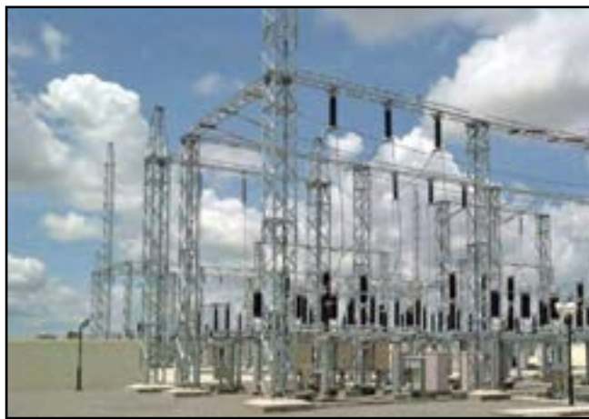
Des installations électriques
