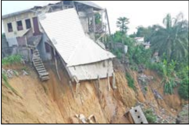
Une vue des dégâts du ravin
