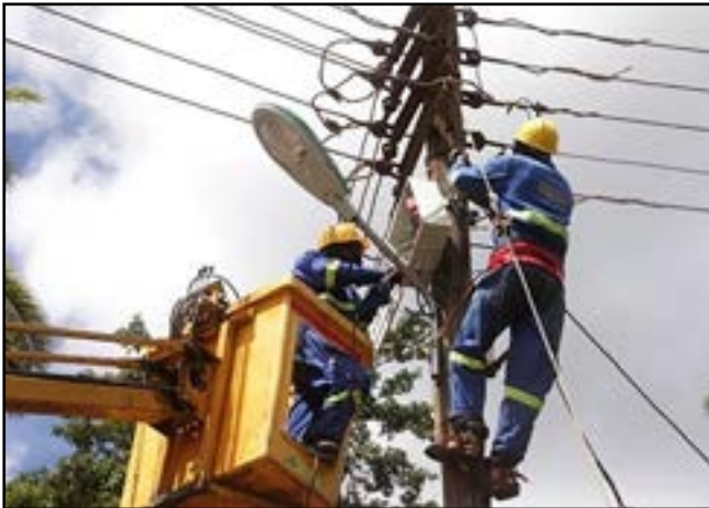
Le tripatouillage des câbles électriques
